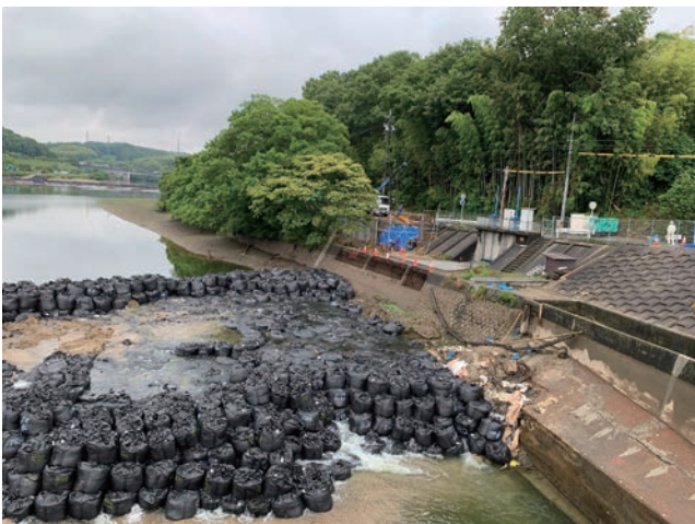
写真 2-1-1 明治用水頭首工の漏水事故。筆者撮影
