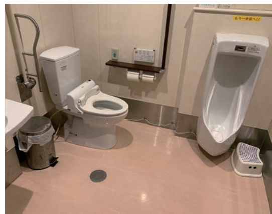
写真 1-2-5 雨水を使用した施設内のトイレ。 橋本淳司撮影
